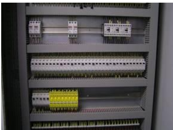
Rozvodna s řídicím systémem III
