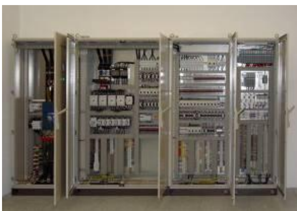
Rozvodna s řídicím systémem I
