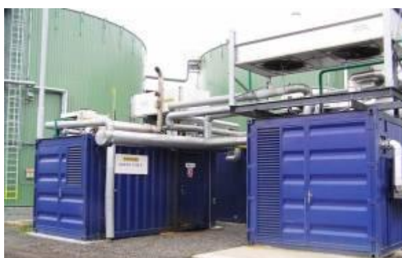
Pohled na 2 kogenerační jednotky
