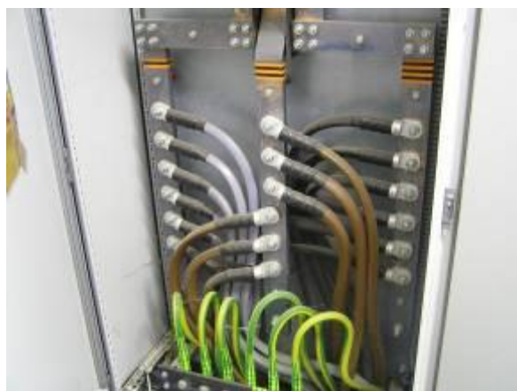
Rozvodna – část elektro
