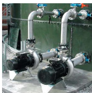
Pohled na čerpadla
