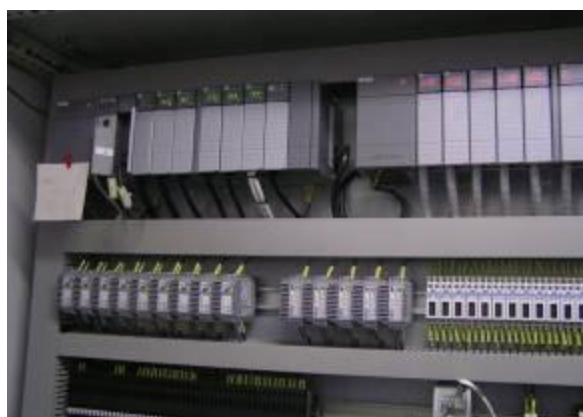
Rozvodna s řídicím systémem II
